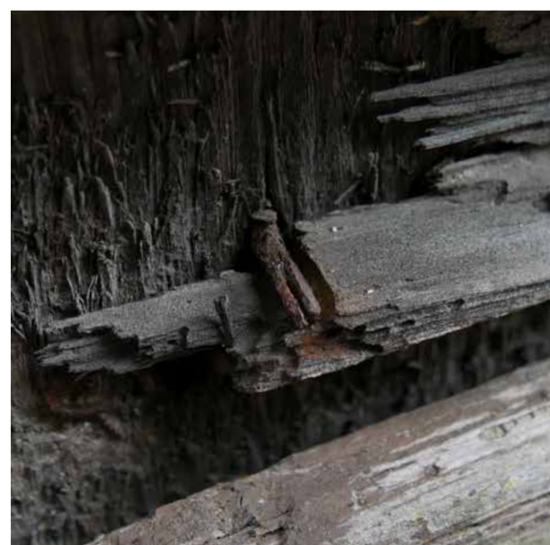
Pointe de clou visible côté extérieur
