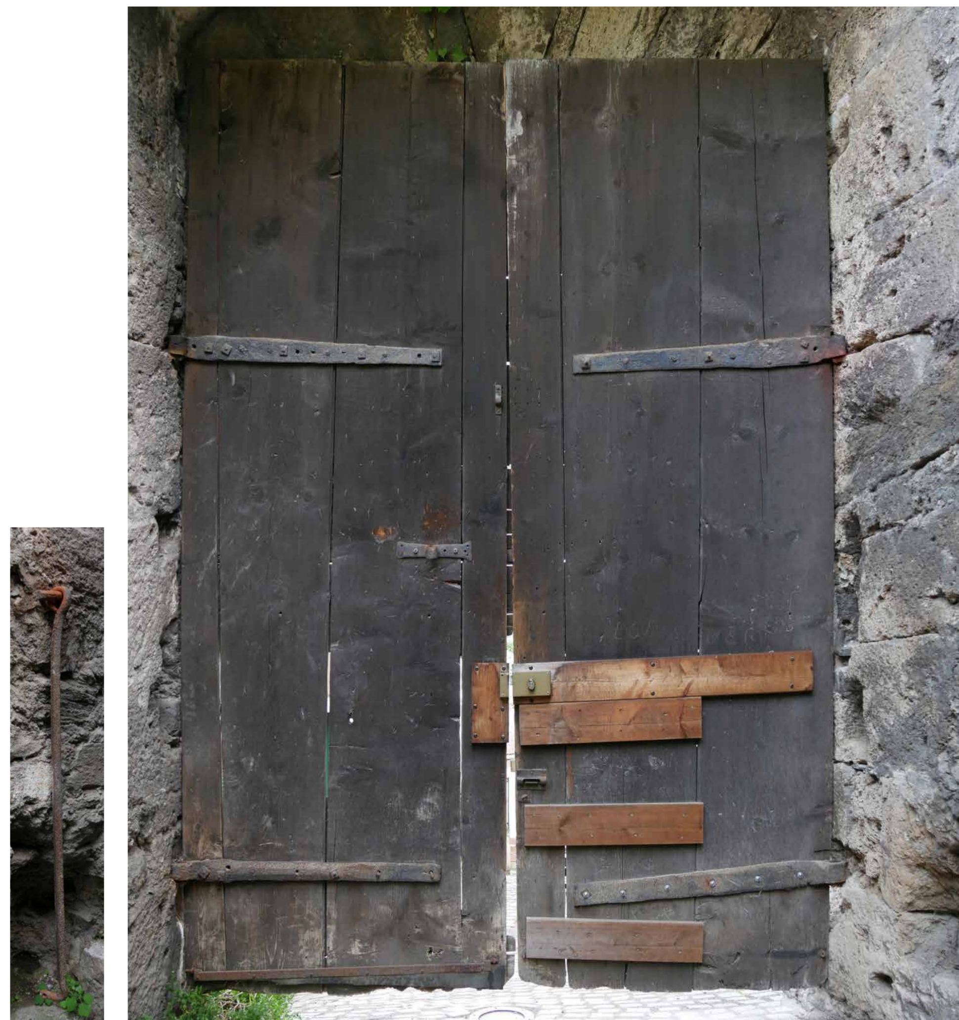
Barre de fermeture en fer forgé ; Porte (interne), faisant état de nombreux éléments ajoutés pour renfort, des pentures manquantes, et de l'affaissement des pentures du vantail de droite
