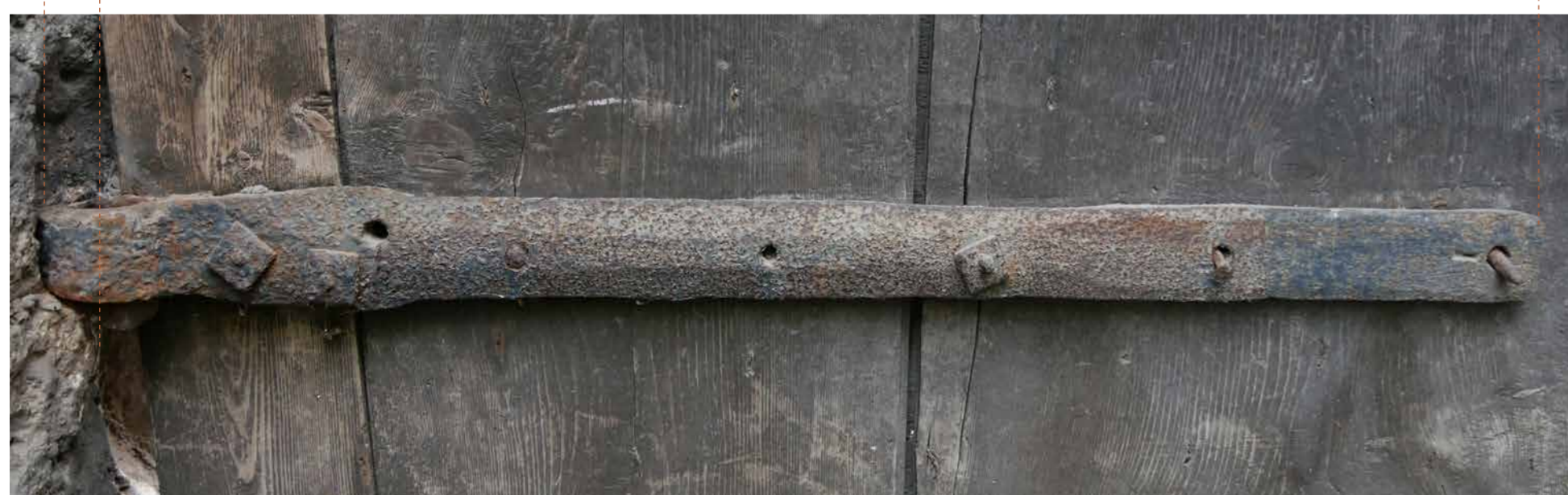
Penture courante à col droit en fer forgé, basse intérieure gauche - état correct : corrodée par le temps, traces de rouille visibles
