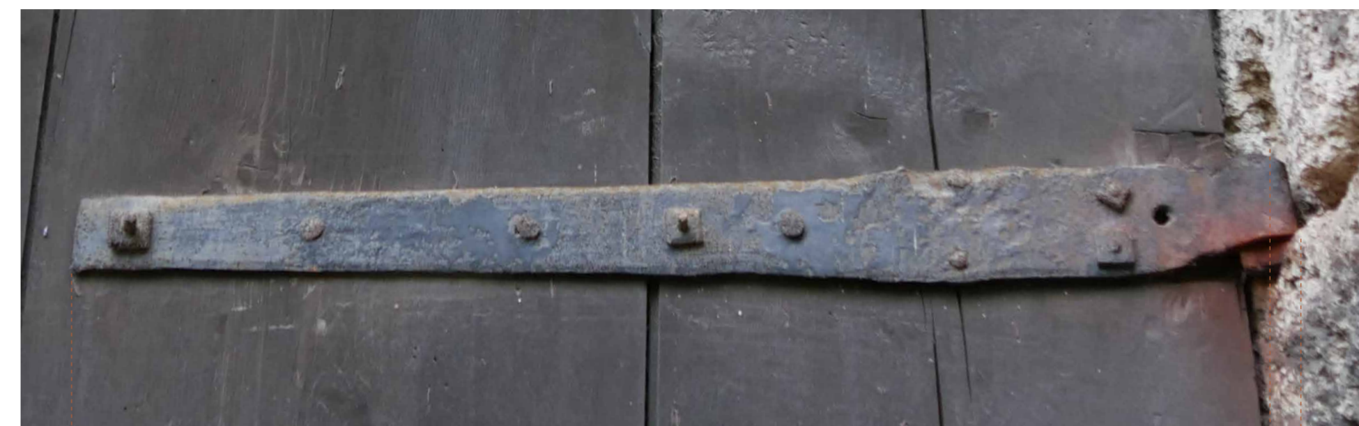
Penture courante à col droit en fer forgé, haute intérieure droite - état correct : corrodée par le temps, traces de rouille visibles
