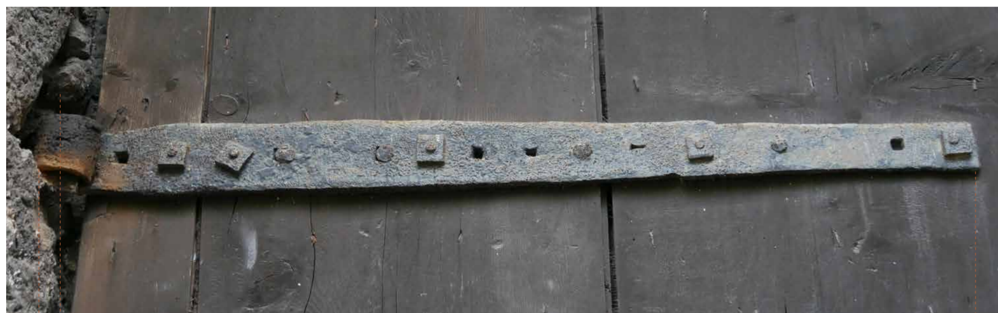
Penture courante à col droit en fer forgé, haute intérieure gauche - état correct : corrodée par le temps, traces de rouille visibles
