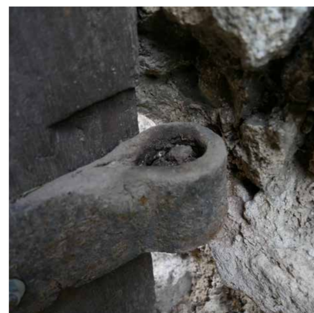
Oeil de la penture réalisé par roulage et soudure à la forge
